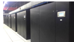
IDC Фэнцин Цзиньшань при China Telecom Шанхай
